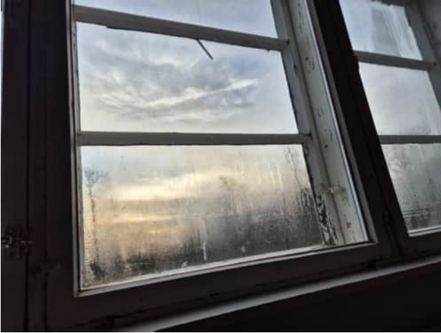
Kuva 34 Merkittävästi kosteutta lasivälissä
