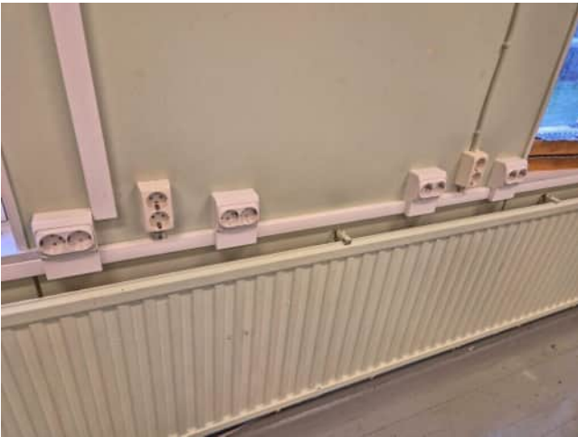
Kuva 91 Lisättyjä, pitkiä pistorasiaketjuja
