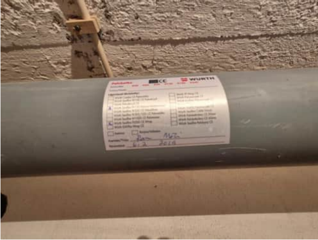
Kuva 93 Palokatkon asennustarra vuodelta 2019
