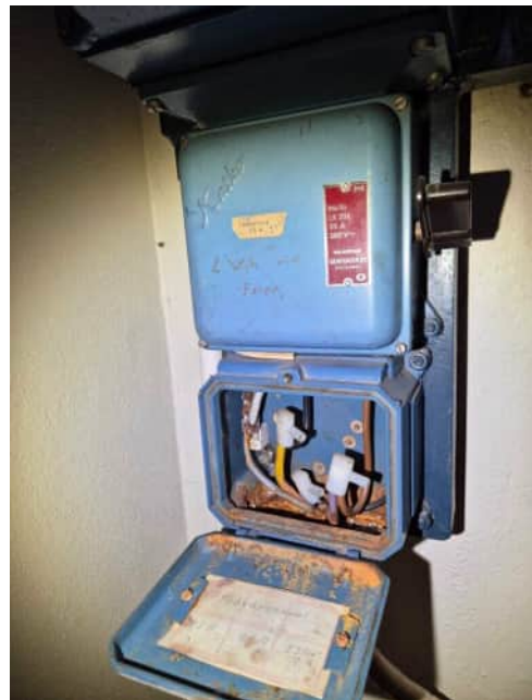
Kuva 88 Hapettuneita pääkytkimen johtimia
